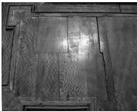
Рис. 11. Шуваловский дворец. Дверное полотно, облицованное чинарой. Фрагмент. Следы предшествующих ремонтов
