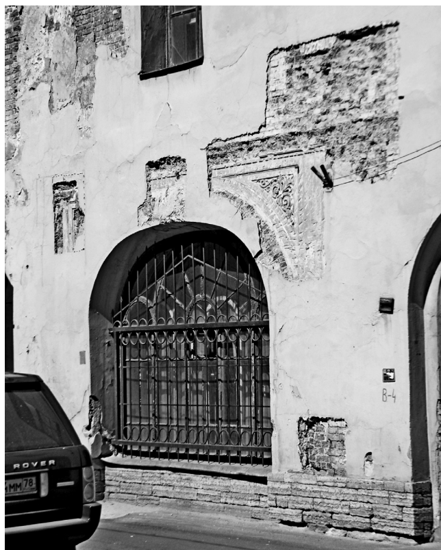
Рис. 10. Следы декора начала XVIII века на фасаде сохранившегося фрагмента Старого Гостиного двора на Васильевском острове
